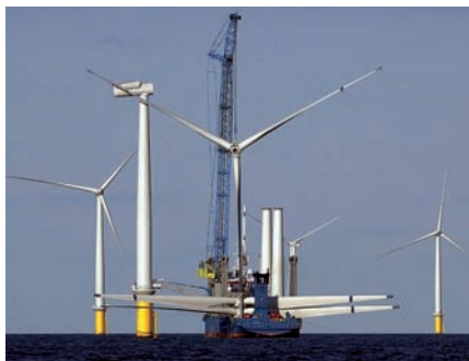
Parque eólico offshore Horns Rev II.
