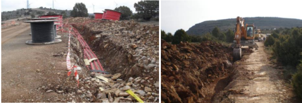
Figura 4. Zanjas en parque eólico para la instalación de los cables de evacuación de energía eléctrica.
